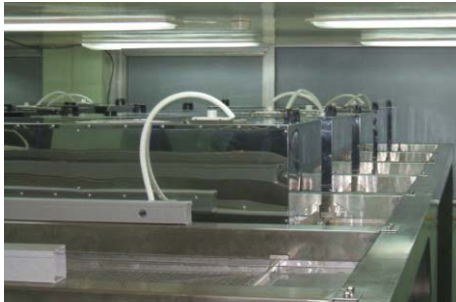
Fan Filter Units
